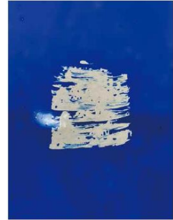
塗膜產生剝離
